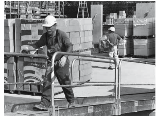
Bild 7: Sicherer Baustellenzugang mit Seitenschutz und Querstreben. Baustellenzugänge müssen mindestens 1 m breit sein.
